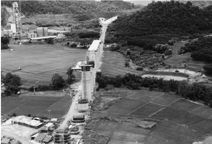
図表7 ルアンナムターウドムサイ間的高速鉄道橋脚建設状況
